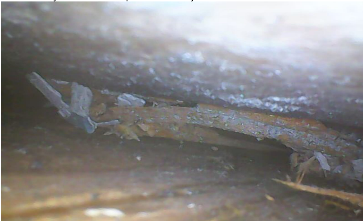
Il nr 7 Ściany prezbiterium przestrzeń pomiędzy deskami i belkami , cz . górna – brak warstw malarskich
